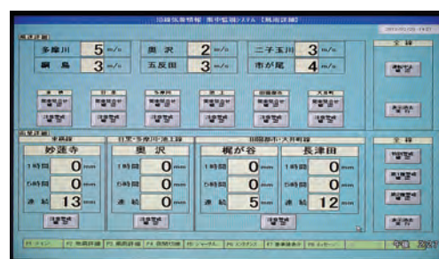
気象情報集中監視システム画面(風速・雨量)
