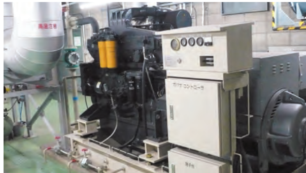
駅の非常用発電機
