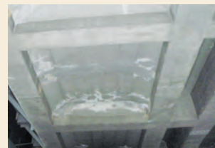
高架橋長寿命化対策前
