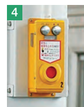
非常停止ボタン
