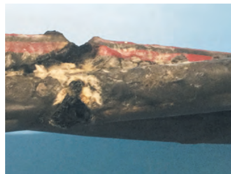
ケーブル損傷箇所拡大
