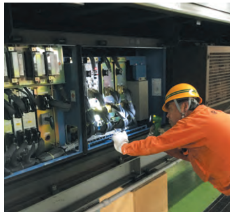
制御装置の点検
