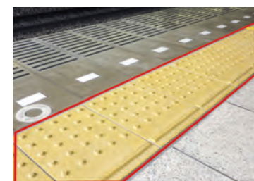
内方線付き点状ブロック
