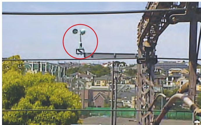
東急線沿線に設置した風速計
